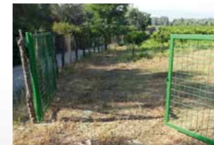
Cancello divelto in uno dei terreni confiscati.
