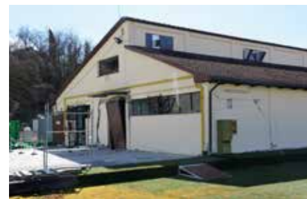
Lo scarico merci lesionato della Coop di Norcia ormai non più agibile.
